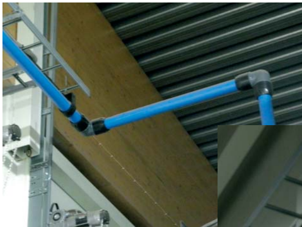
Vasemmalla ainet-putkisto. Alla helppo alasotto runkoputkesta.
